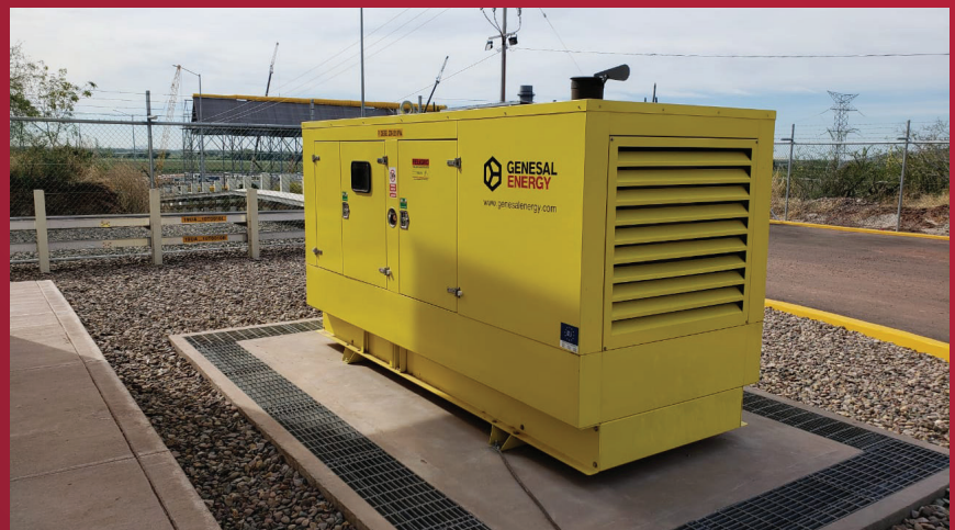
Grupos electrógeno instalado en la subestación eléctrica de Topolobampo II
